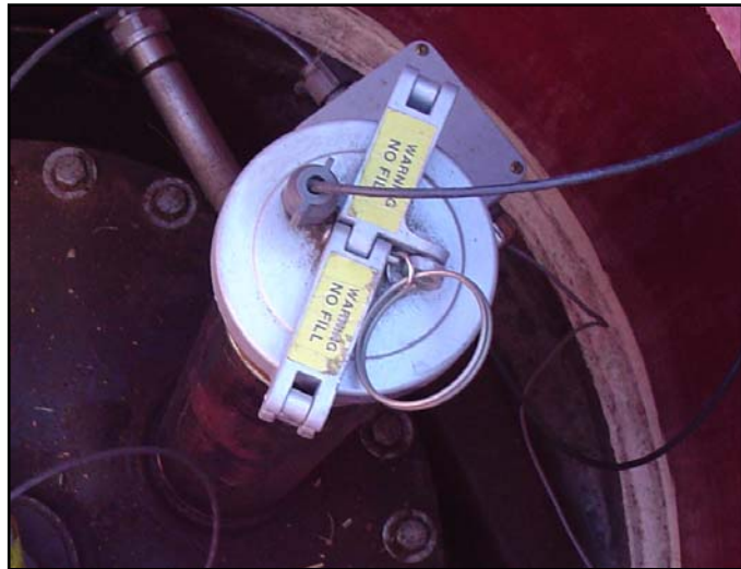
Tank ATG Riser
